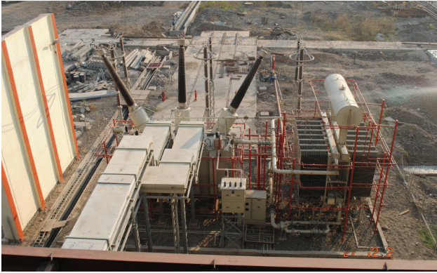
भुसावळ स्टेशन ट्रान्सफॉर्मर संच ४ (२x५०० मेगावॉट बीएसएल प्रकल्प)
