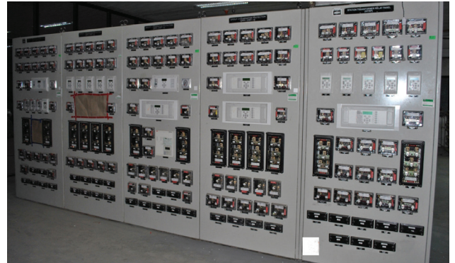
भुसावळ स्टेशन आणि निर्मिती ट्रान्सफॉर्मर प्रोटेक्शन पॅनल संच ५ (२x५०० मेगावॉट बीएसएल प्रकल्प)
