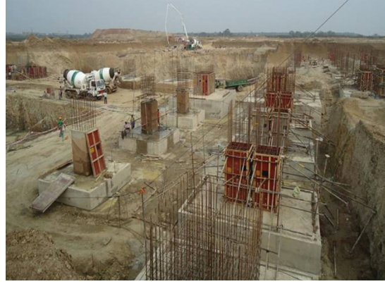
कोराडी टर्बाइन हॉल संच क्रं ९ (३×६६० मेगावॉट प्रकल्प)
